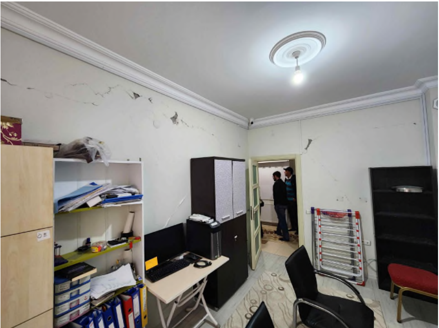
사진1. 지진으로 균열이 생긴 교회 건물
